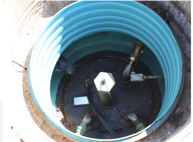
Foto 8: Monitoramento intersticial nos tanques.
