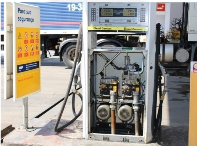
Foto 5: Bombas de abastecimento equipadas com válvulas de retenção e sump.
