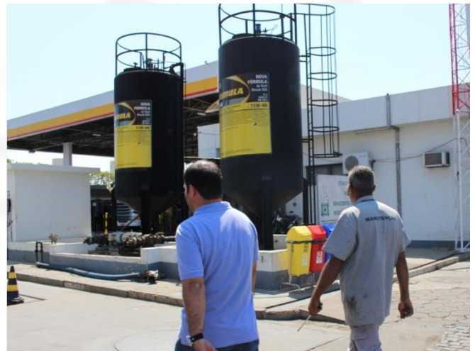
Foto 4: Tanques de armazenamento de óleo lubrificantes.
