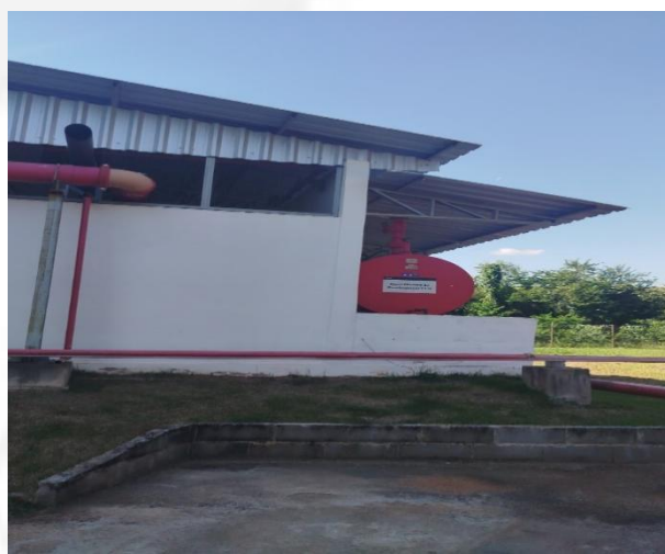
SASC da bomba do sistema de incêndio – intervenção em APP
