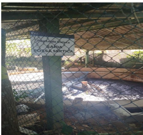
Fossa central – filtro
