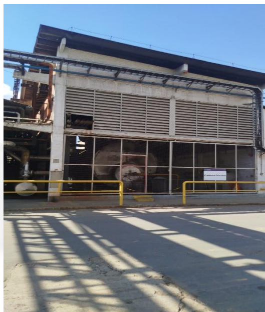
Cômodo das caldeiras de geração de vapor
