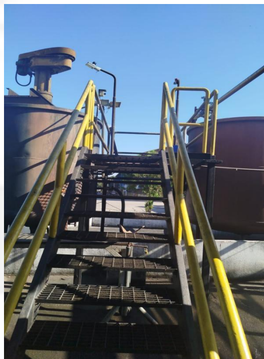
Tratamento físico-químico-efluente fábrica de tintas
