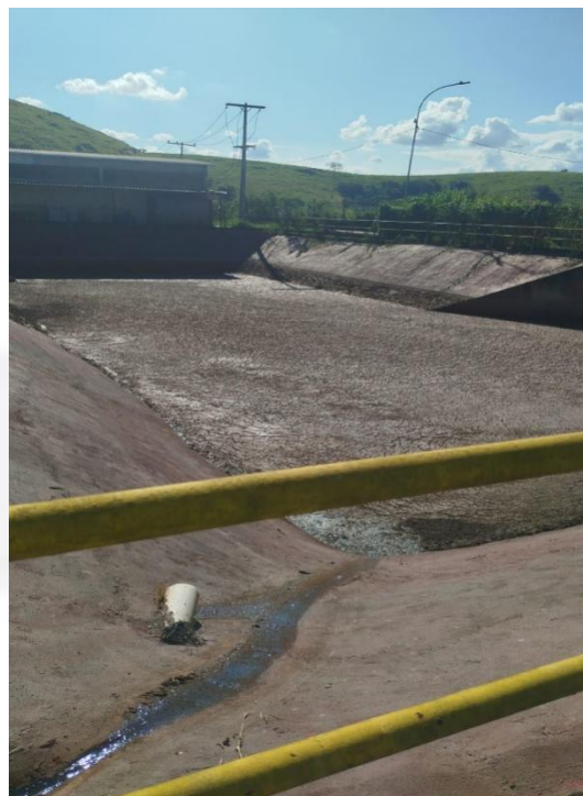
Lagoa de emergência da ETE industrial
