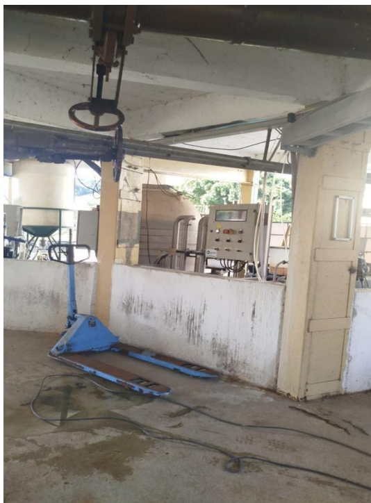
Depósito de insumos da ETE industrial
