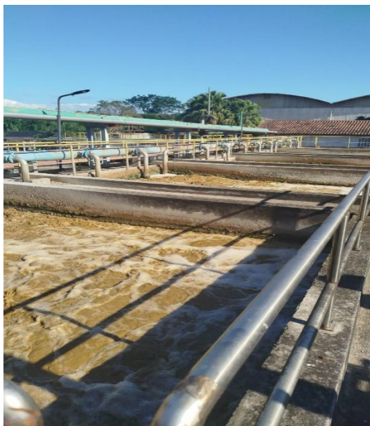
Reatores aeróbios - ETEI
