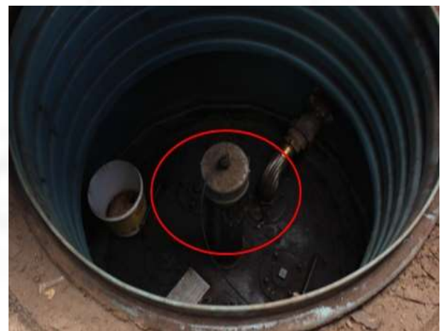
Foto 04: Sistema de monitoramento intersticial instalado nos tanques.
