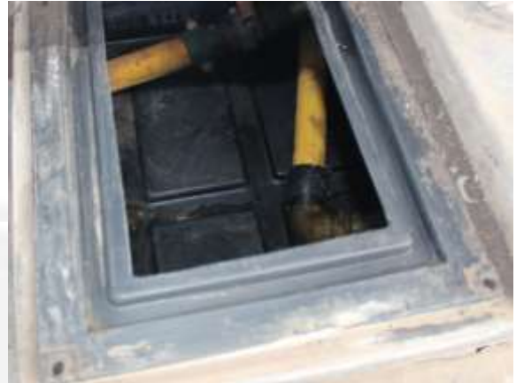
Foto 02: SUMP dos filtros de diesel.
