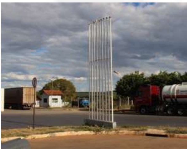
Foto 05: Sistema de respiros dos tanques.
