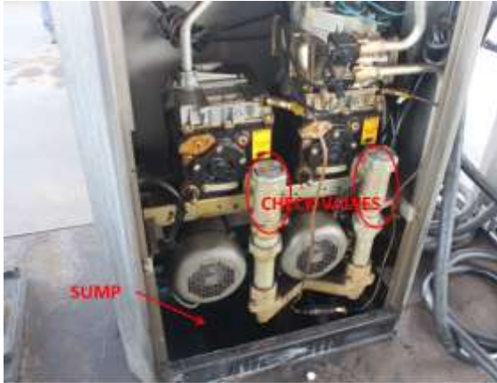
Foto 01: Medidas para contenção de vazamento nas bombas de abastecimento.
