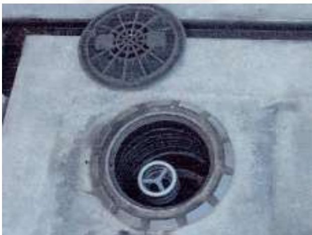
Foto 03: Descarga selada (sump, cruzeta e válvula de anti-transbordamento).
