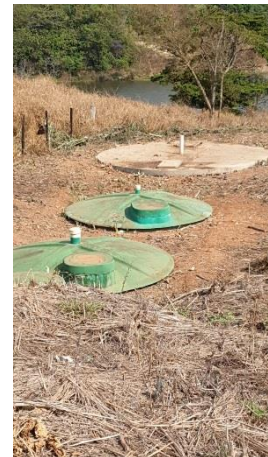
Foto 02. Sistema de Tratamento de Efluente Sanitário
