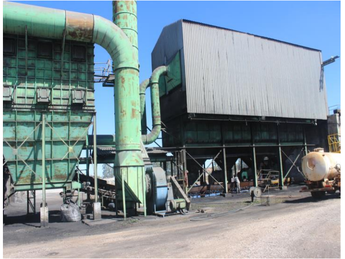
Foto 4: Despoeiramento da descarga de carvão
