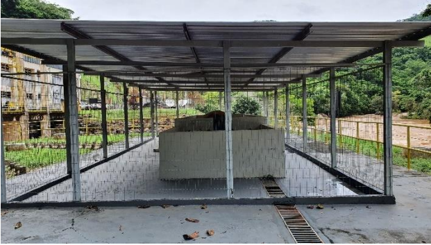
Caixa Separadora de Água e Óleo
