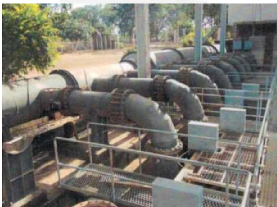
Figura 03. Área de bomba
