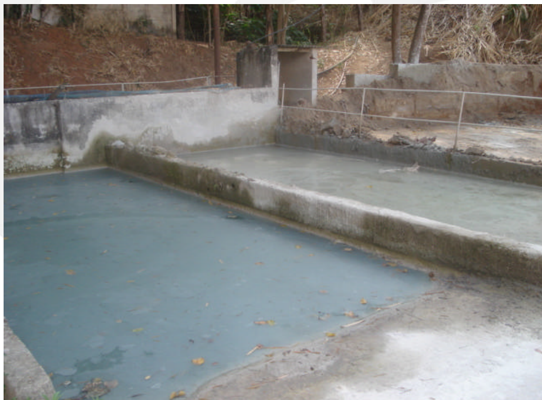
Fig. 04: Sistema "bate-lastro", que recupera parte das águas de lavagens das betoneiras e do sistema de aspersão contra poeiras.
