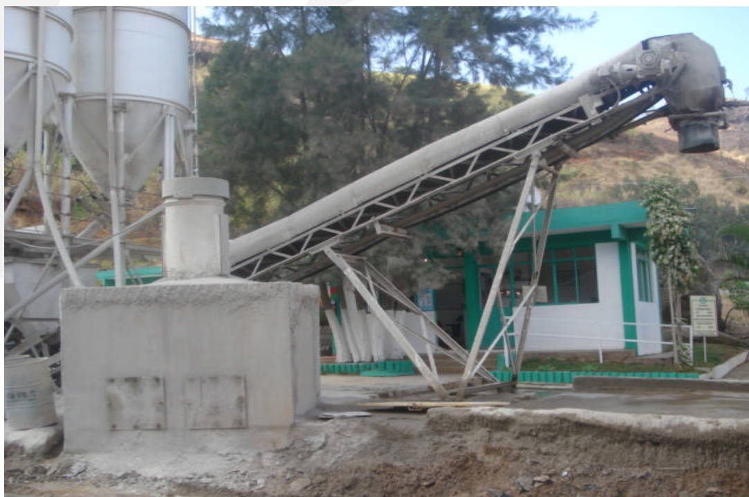
Fig. 02: Silos de estocagem de cimento (à esquerda) e correia transportadora que leva os agregados e o cimento até ao caminhão-betoneira, que promove a mistura dos mesmos. Note-se o sistema de despeiramento sobre a correia.
