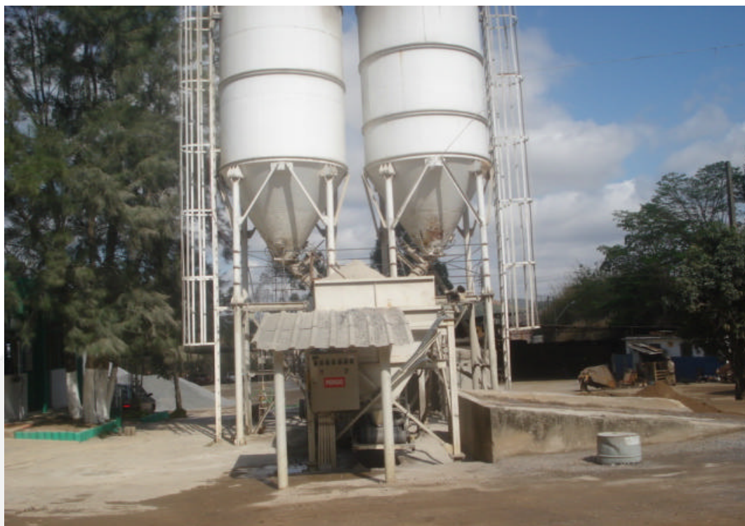
Fig. 01: Silos de estocagem de cimento
