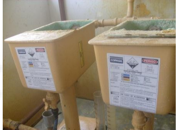
Foto 02. Dosadores de sulfato de alumínio (coagulante)
