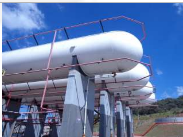
Foto 02. 4 tanques de armazenamento de GLP
