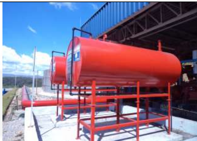
Foto 04. Sistema de combate a incêndio composto por 2 tanques d'água de 450 m³ cada conjuntamente com 2 bombas que operam intermitentemente
