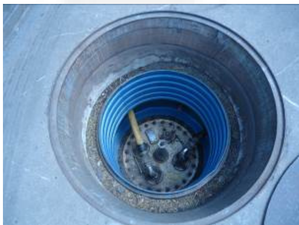
Foto 01. Boca de Visita de tanque de Armazenamento
