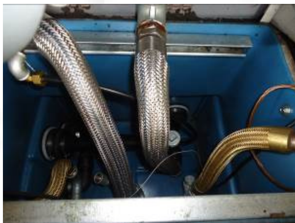
Foto 02. Sump da Bomba de Abastecimento
