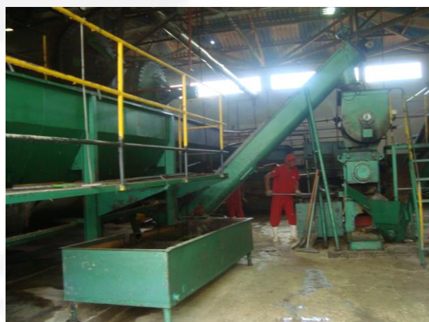
Biodigestores para processamento de subprodutos
