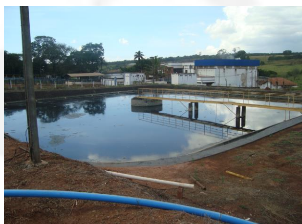
Sistema de Tratamento – Lagoa de Decantação.
