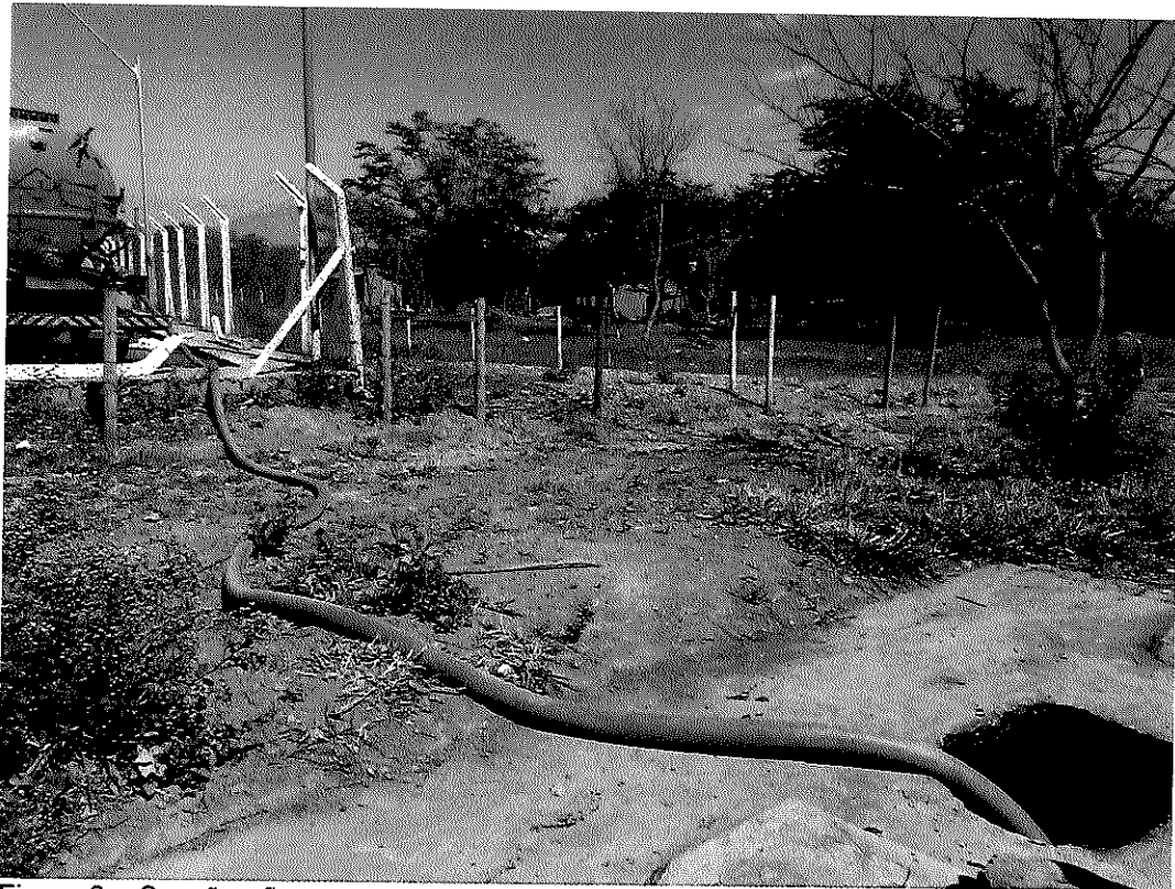
Figura 2 – Sucção efluente sanitário – Fonte: Moura 2015.
