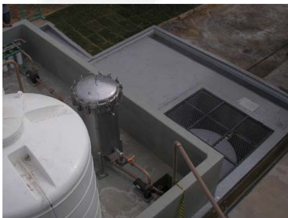
Foto 3. Tanque e filtros dentro do dique de contenção.
