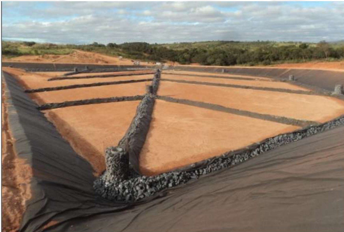
Drenagem de chorume e biogás
