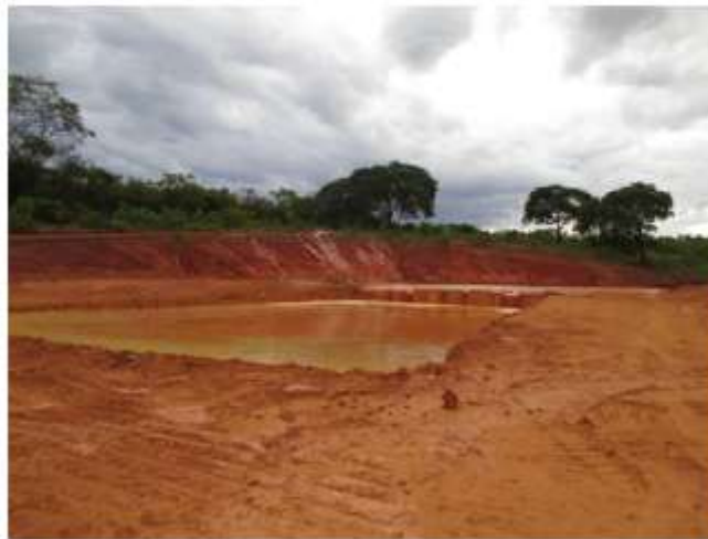
Figura 5 Bacia de acumulação de sedimentos em pleno funcionamento.
