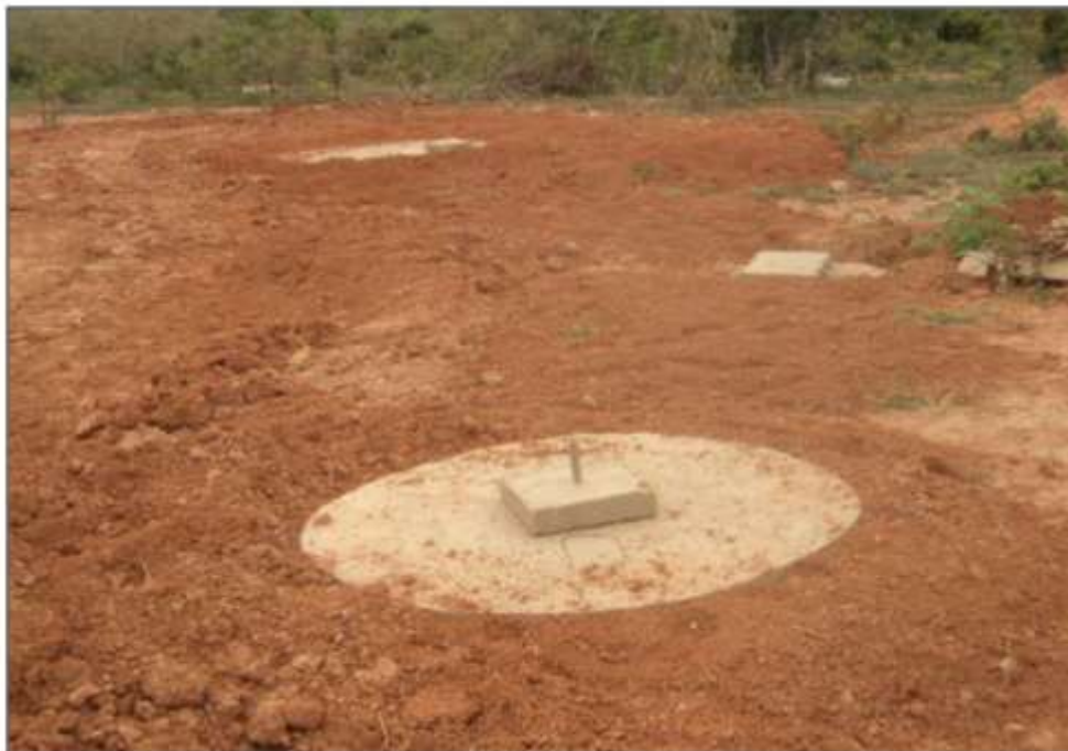
Sistema de tratamento de efluente sanitário implantado
