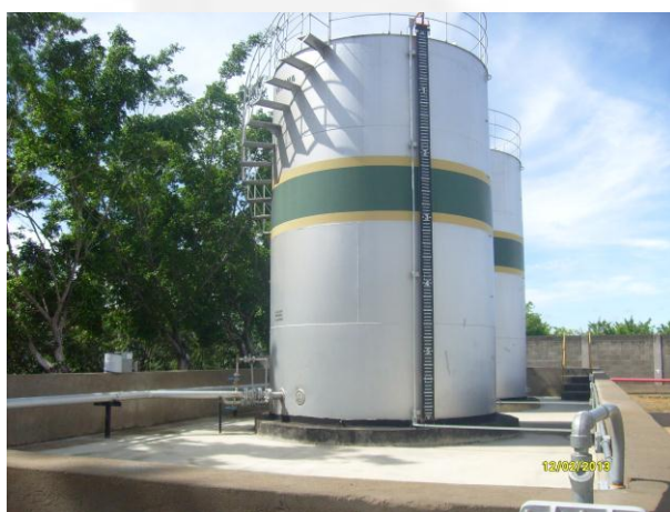
Foto 03. Tanques de armazenamento de Diesel com bacia de contenção
