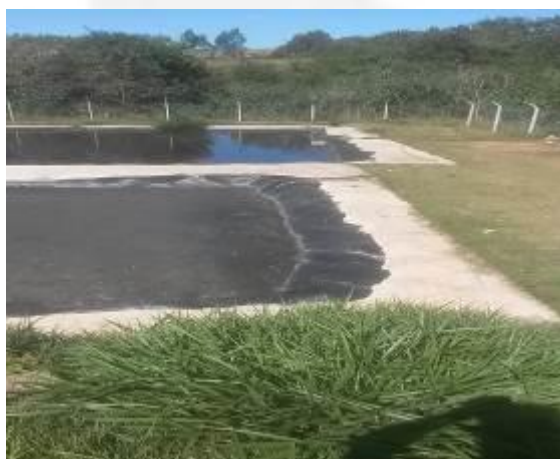
Foto 03. Lagoas de estabilização.
