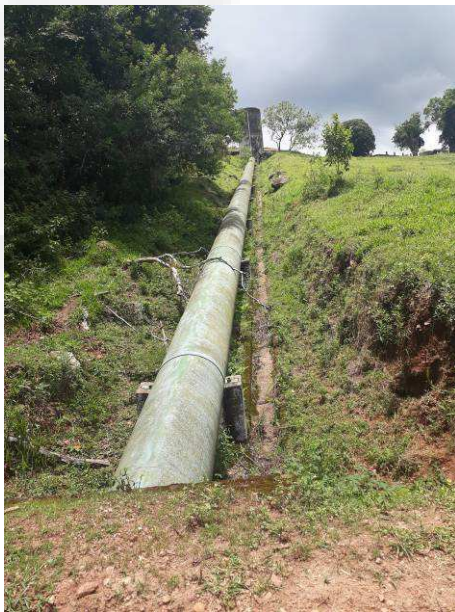
Foto 03. Chaminé de equilíbrio e conduto forçado
