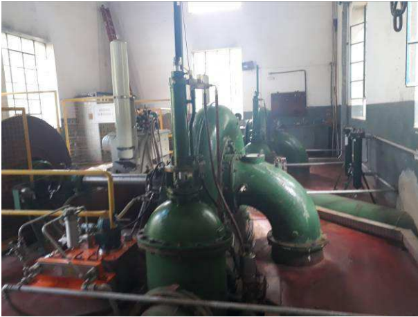
Foto 05. Interior da casa de força
