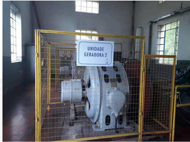
Foto 06. Interior da casa de força
