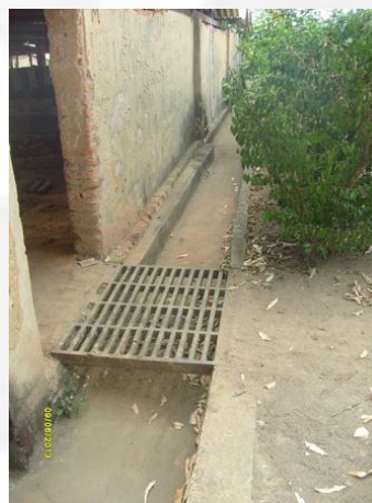
Foto 04. Sistema de drenagem pluvial
