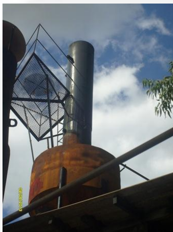
Foto 01. Lavador de gás
