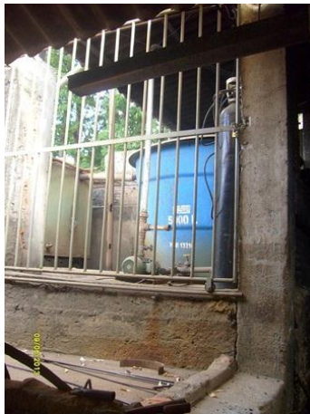
Foto 05. Sistema de recirculação de água.
