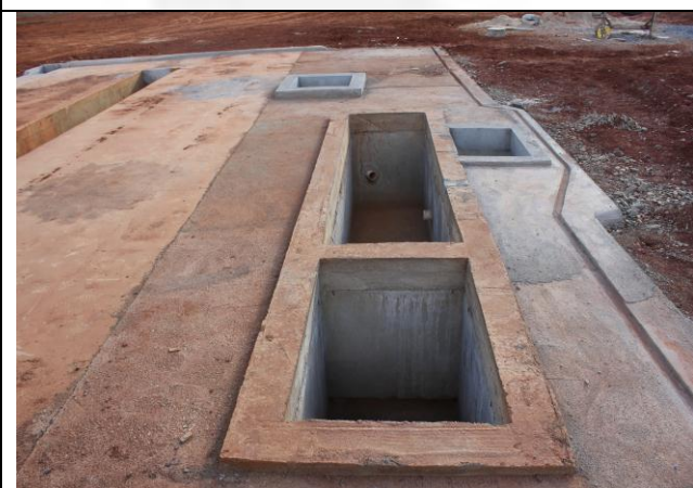
Foto 03: caixa separadora de água e óleo.
