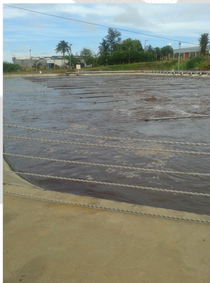
Foto 4: Lagoa da ETE
