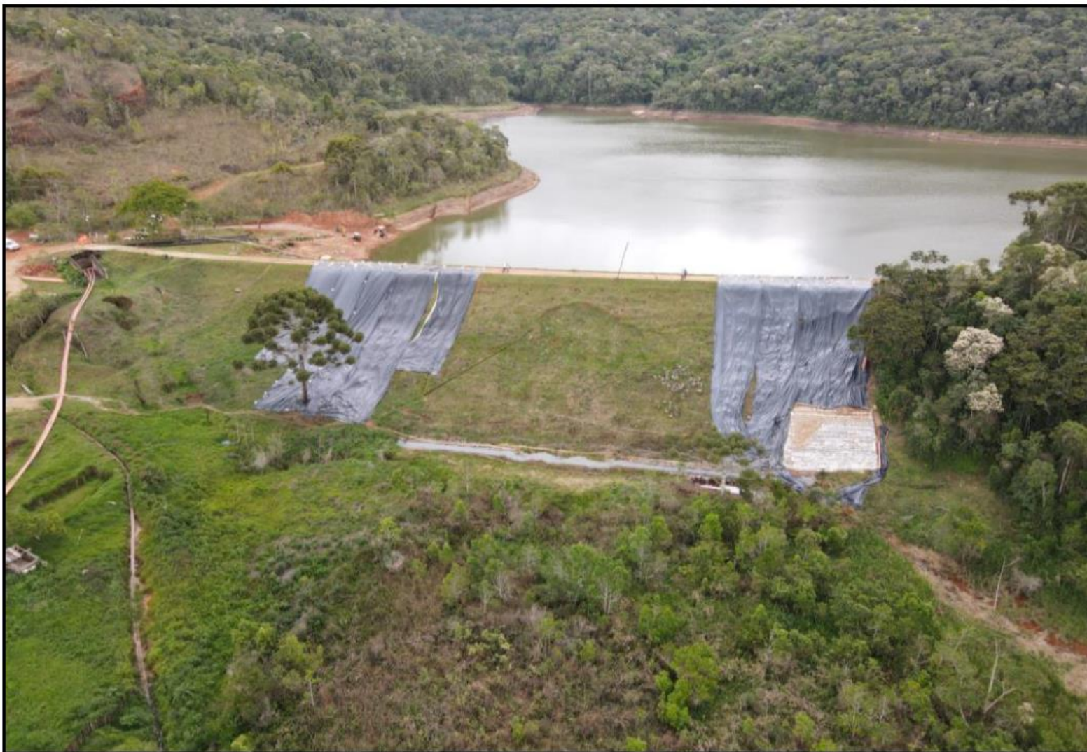
Foto 1 – Vista do talude de jusante da barragem Brejo Grande, inspeção do dia 29/10/2021. Foto: AECOM, 2020.
