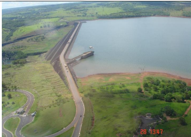
Foto 03: Barramento. Fonte: Relatório IC (documento SEI nº 21785062).
