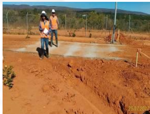
Foto 08. Caixas passagem sistema de drenagem
