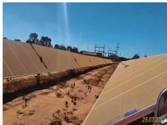
Foto 06. Painéis solares instalados
