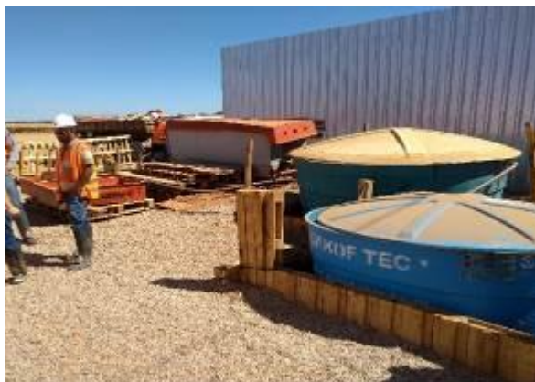
Foto 05. Sistema prévio de tratamento de efluentes (eletrolítico)
