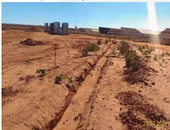
Foto 07. Canaletas sistema drenagem
