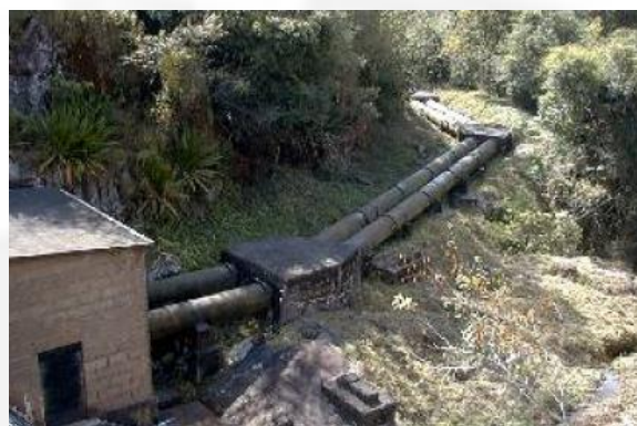
Condutos de adução usina principal
