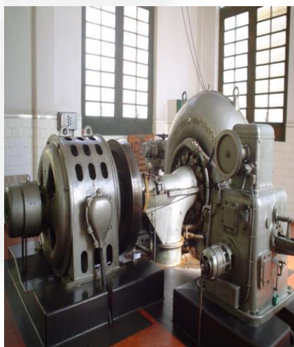
Conjunto turbina e gerador da usina auxiliar
