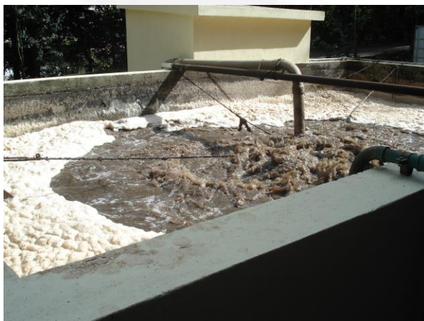
FOTO 03. Reator Biológico Aeróbico
