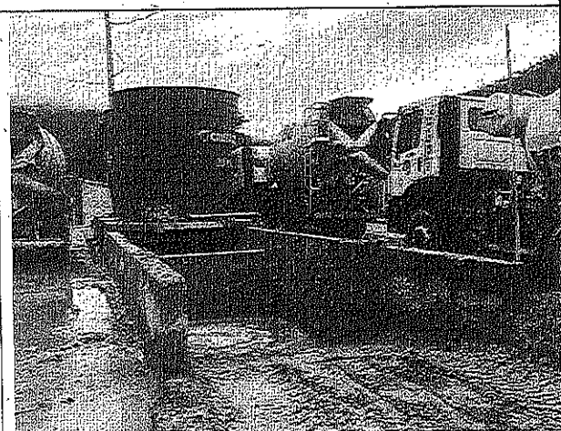
Foto 09. Sistema de decantação – Bate lastro.
