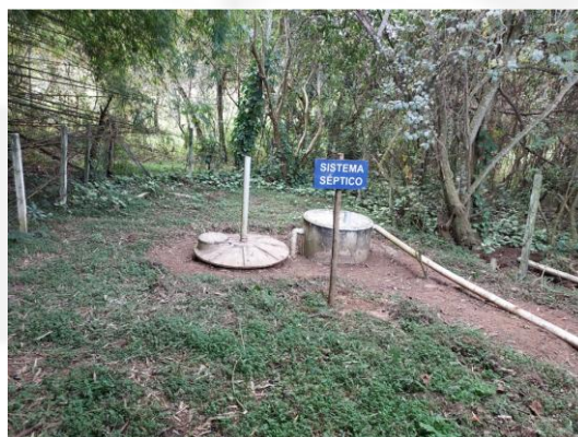
Foto 06. Sistema de tratamento de efluentes sanitários
