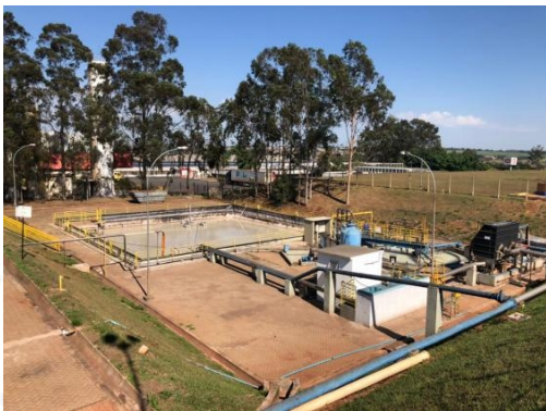
Figura 1- Estação de Tratamento de Efluentes
