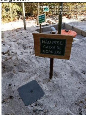
Foto 14. Caixa de gordura.
