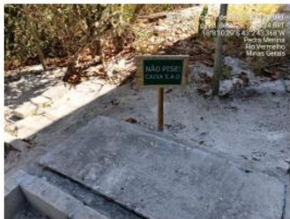
Foto 11. Caixa separadora de água e óleo.
