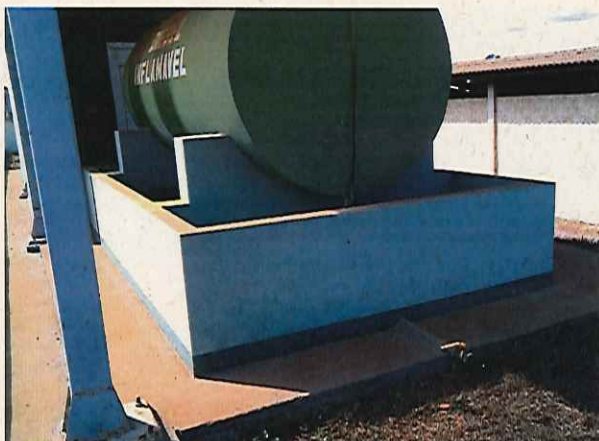
Figura 9. Tanque de combustível (5.000 L)
