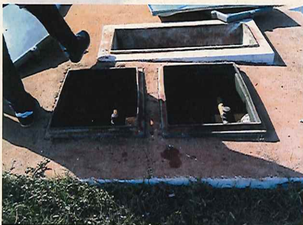
Figura 1. Caixa separadora de água e óleo - CSAO
