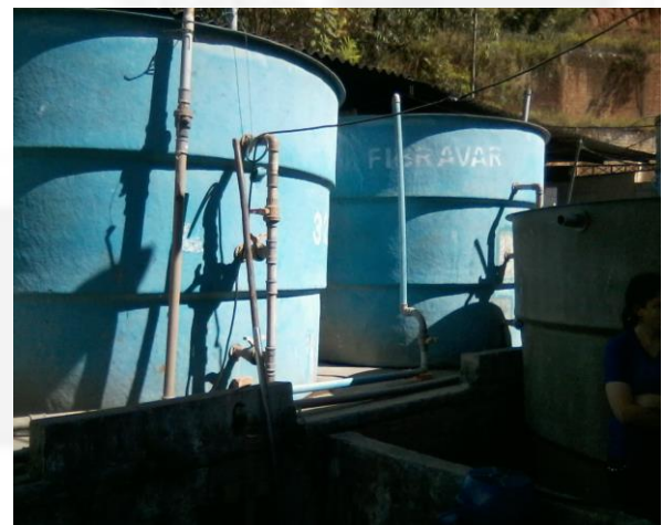
Foto 04. ETE - Estação de Tratamento de Efluentes
