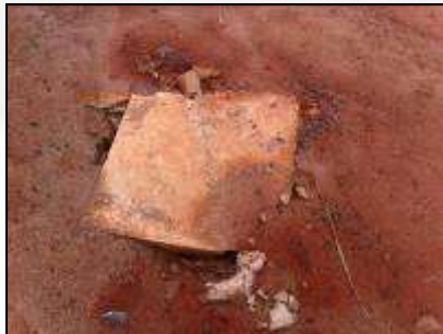
Foto 27: Caixa de passagem danificada
