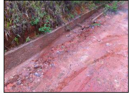
Foto 25: Canaleta danificada e obstruída
