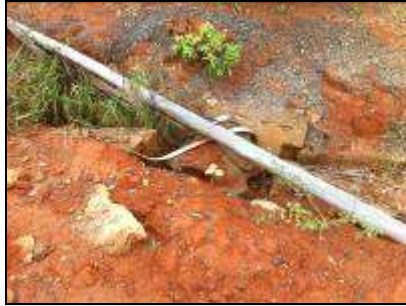
Foto 24: Canaleta danificada e obstruída
