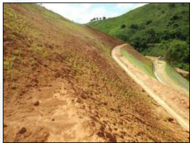
Foto 32: Sistema de drenagem pluvial no pé dos taludes.
