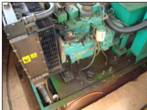
Foto 17: Sistema de contenção de vazamentos instalados sob os geradores.
