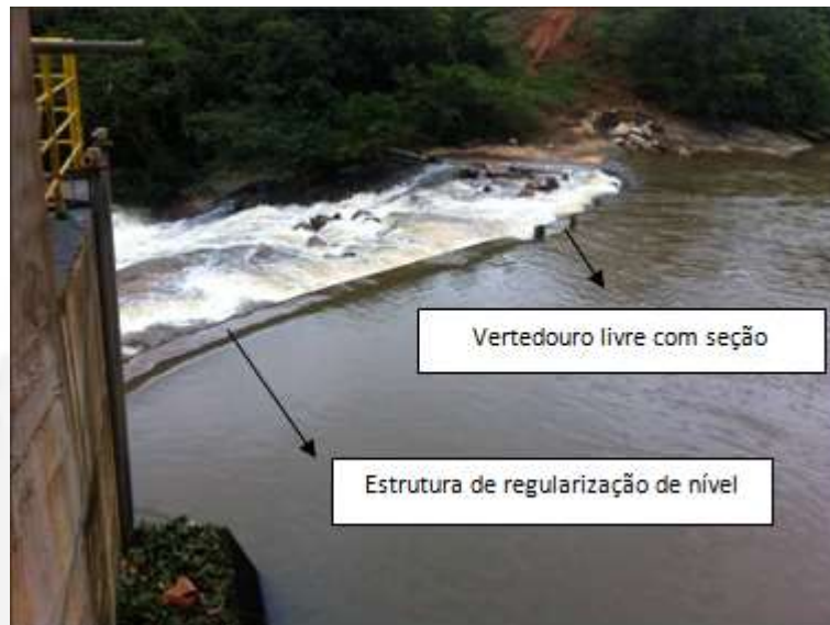
Foto 5: Estrutura de concreto responsável por promover a regularização do nível d'água.
