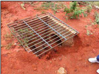
Foto 26: Bueiro danificado e obstruído
