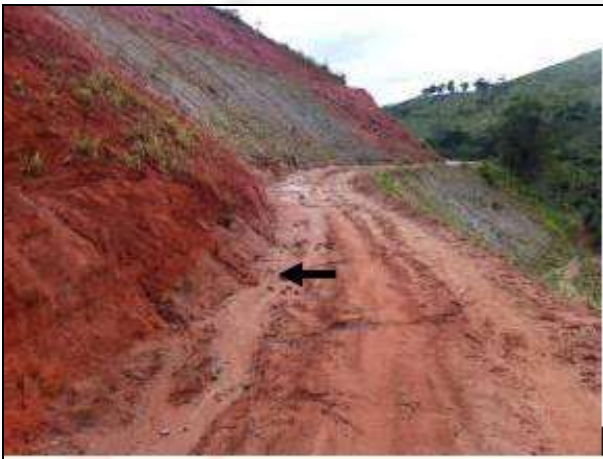
Foto 33: Taludes à montante da casa de força. O Plano de Recuperação de Áreas Degradadas – PRAD executado não apresentou resultado satisfatório, sendo possível observar áreas com solo exposto bem como o completo soterramento das canaletas de drenagem pluvial localizadas no pé do talude.
