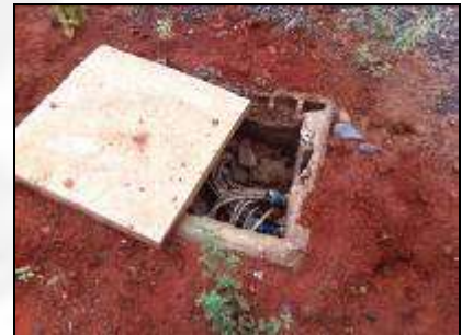
Foto 28: Caixa de energia danificada
