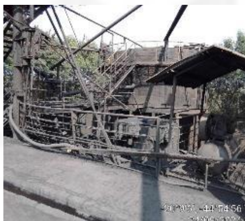
Foto 04. Tanque recirculação de água.
