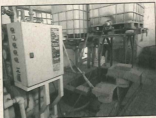
Foto 03. Gerador e tanques de óleo diesel.
