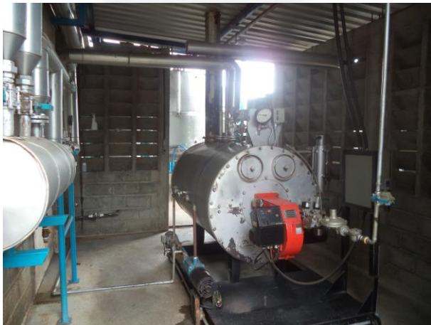
Foto 01. Caldeira a gás GLP
