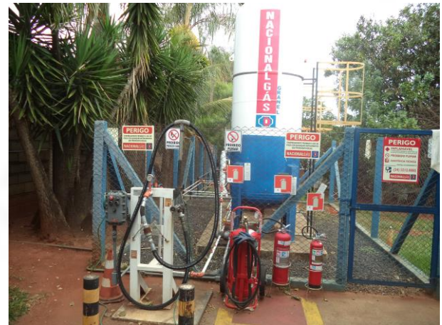
Foto 02. Central de GLP (caldeira e empilhadeiras)
