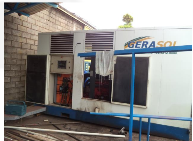
Foto 04. Gerador de energia
