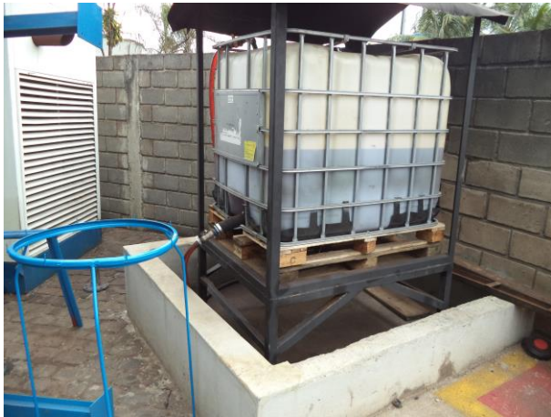
Foto 05. Tanque de combustível do Gerador
