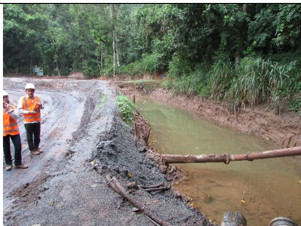
Fotografia 07: Conjunto de Baías do Booster .
