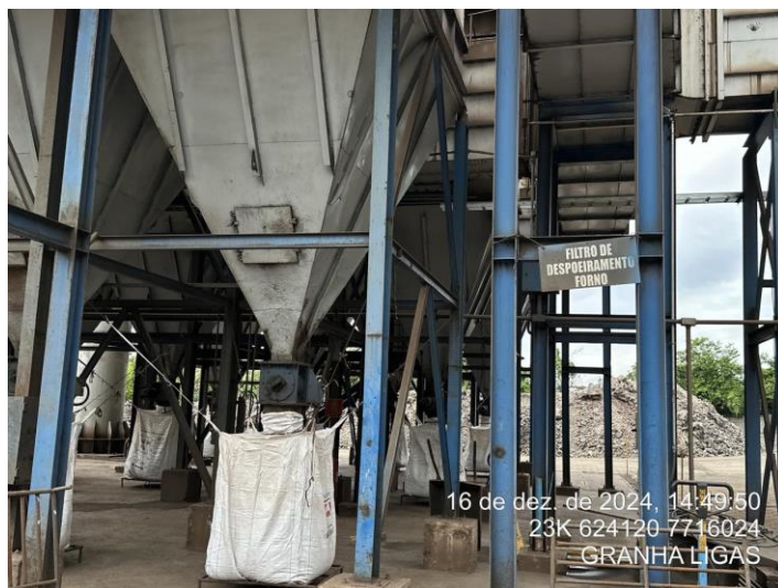
Foto 12: Área dos filtros de mangas associados aos fornos.
