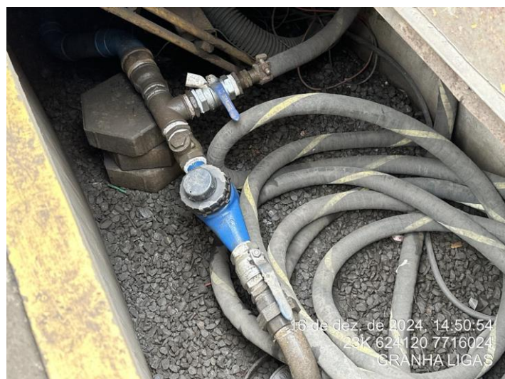
Foto 60: Hidrômetro associado ao poço artesiano.
