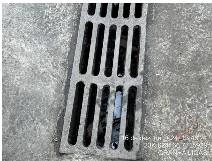
Foto 54: Efluentes com sabão em caixa de passagem próximo à oficina industrial.
