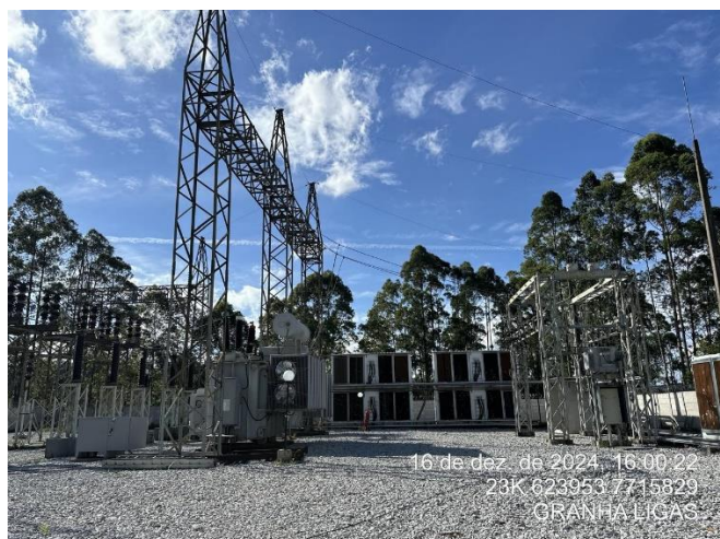
Foto 1: Subestação da Granha Ligas.
