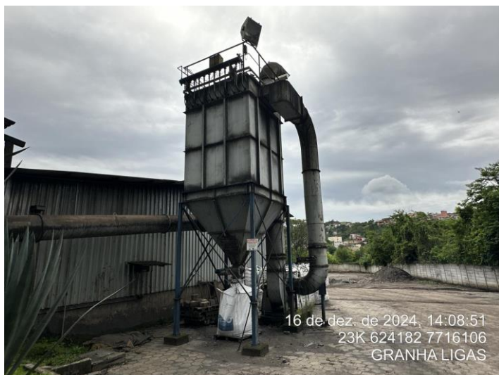
Foto 19: Filtro de mangas associado a britagem do empreendimento.
