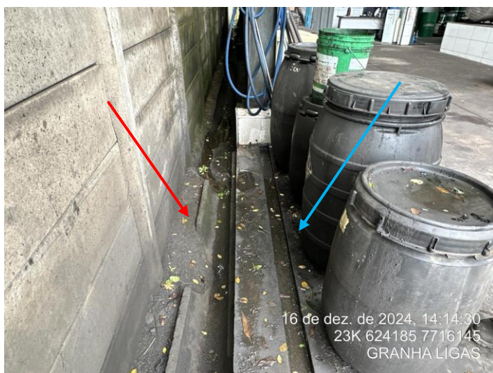
Foto 41: Seta vermelha indicando canal de efluentes pluviais, e a seta azul evidencia a canal da oficina mecânica. Possível observar a proximidade dos dispositivos.
