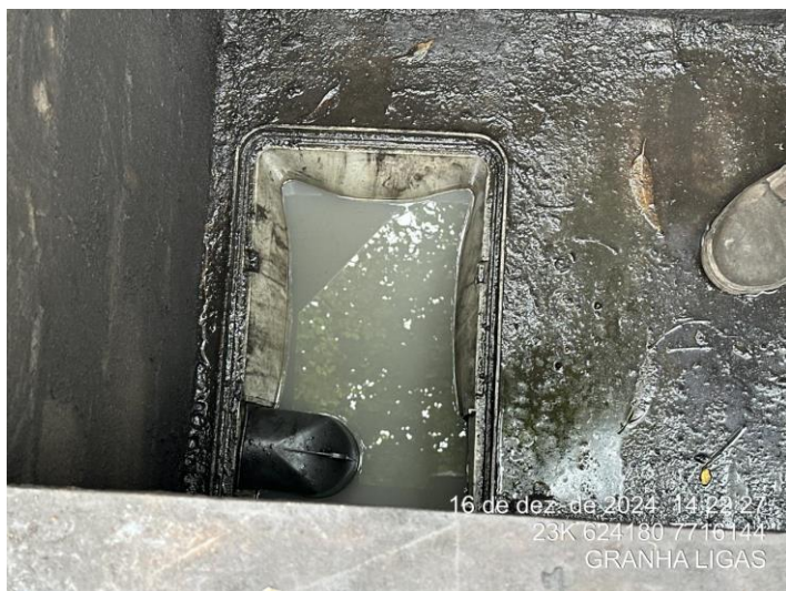
Foto 37: Saída da CSAO associada à oficina mecânica e lavador de veículos.
