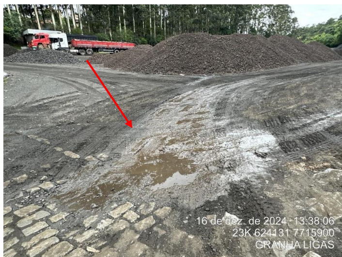
Foto 52: Caminho preferencial de escoamento dos efluentes superficiais advindos do pátio de matéria-prima.
