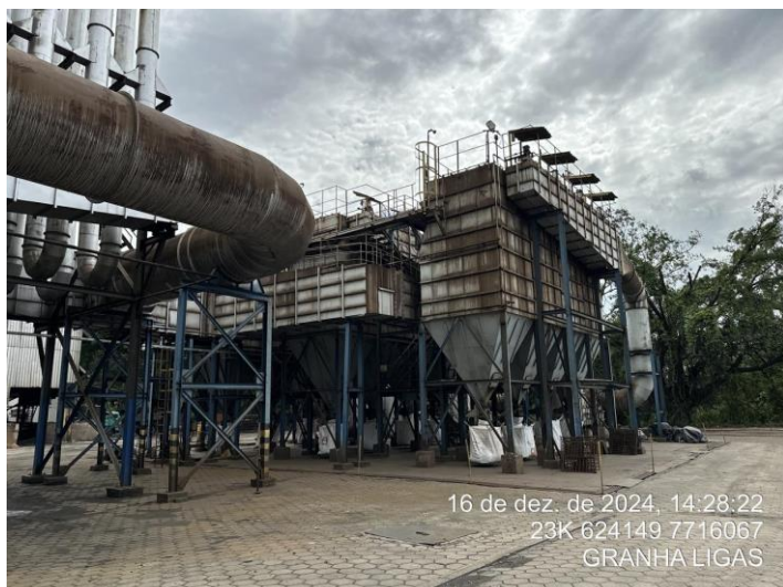
Foto 13: Vista do complexo dos filtros de mangas dos fornos do empreendimento.
