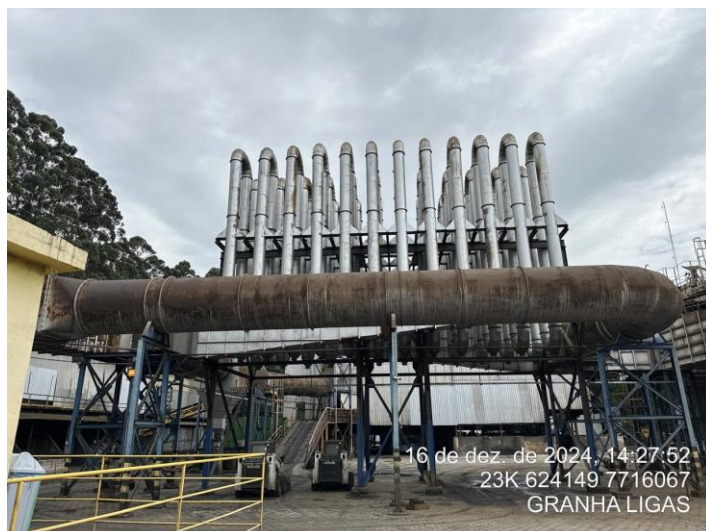
Foto 14: Tubulação para resfriamento dos gases advindos dos fornos.
