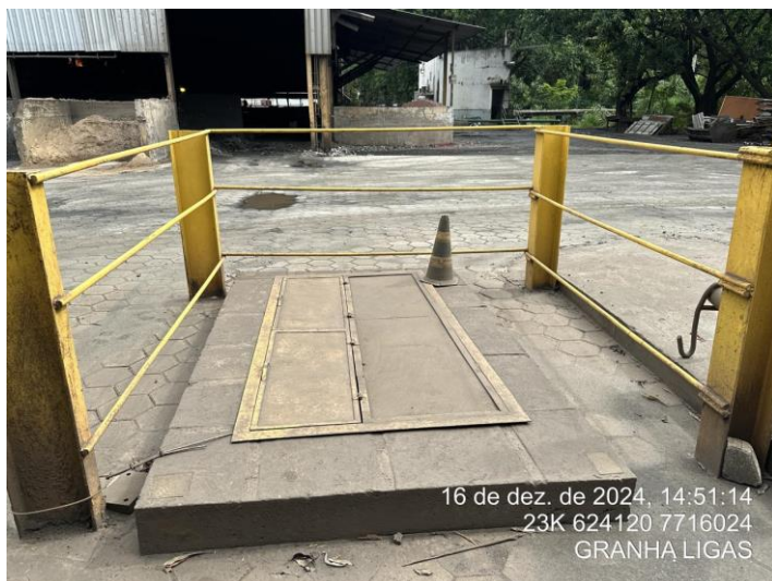
Foto 61: Cercamento e chapa protetora do poço artesiano.
