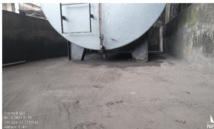
Foto 48: Vista interna do tanque de diesel. Possível observar mancha de combustível embaixo do reservatório.
