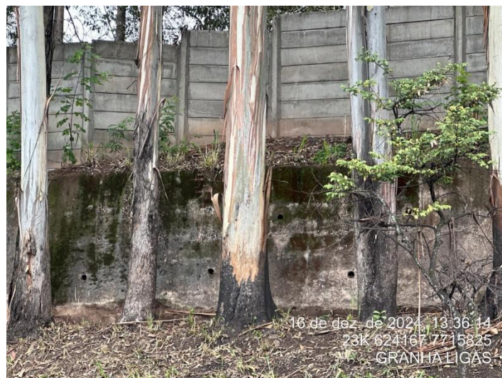
Foto 56: Aberturas no muro do empreendimento, por onde ocorre o escoamento dos efluentes da drenagem superficial advindos da linha férrea.
