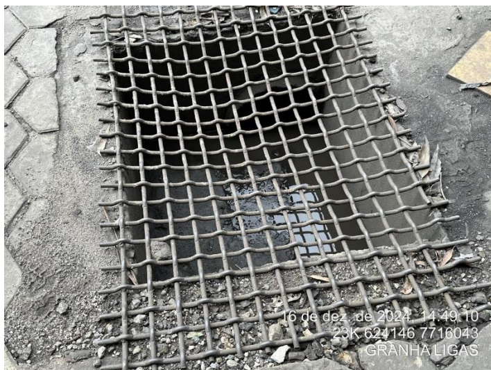
Foto 55: Caixa de passagem de efluentes com acúmulo de sedimentos.
