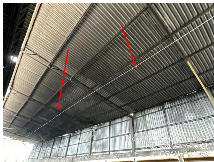
Foto 6: Setas vermelhas indicando pontos de aspersão do galpão de armazenamento de carvão.
