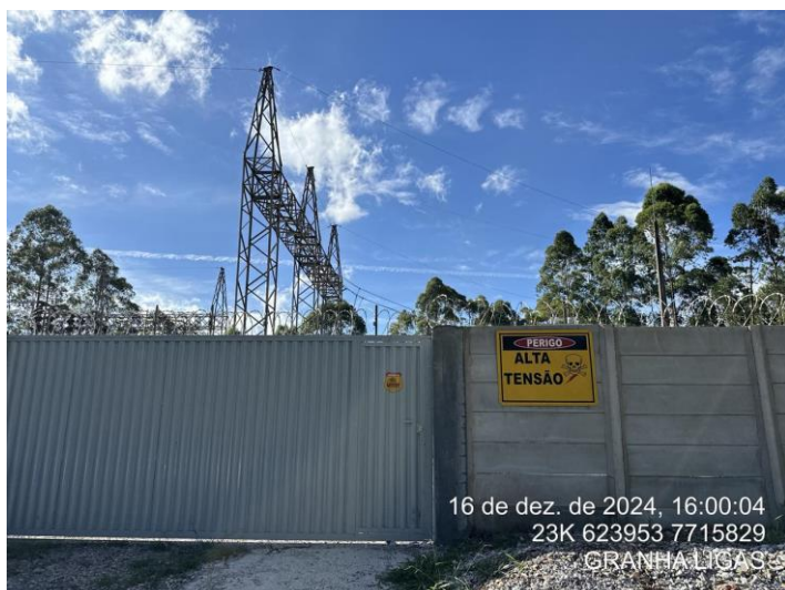
Foto 3: Entrada da subestação, com sinalização.
