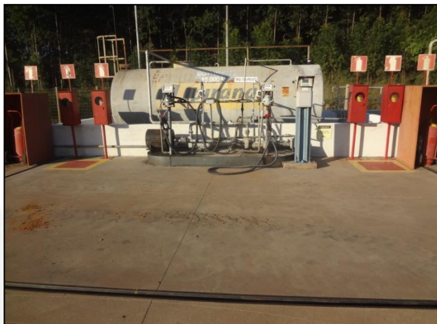
Foto 06 – Ponto de abastecimento de combustível (VISTORIA SUPRAM/LM, 2019).
