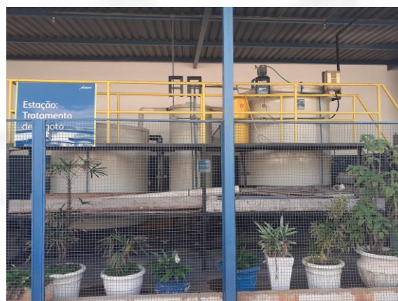
Estação de tratamento de efluentes
