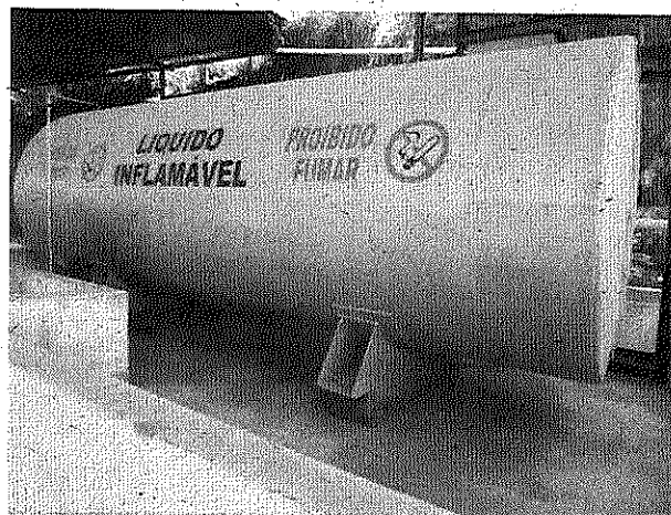
Foto 04 – Tanque de combustível com caixa de contenção em alvenaria.
