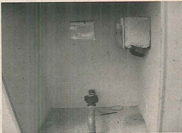
Foto 05. Hidrômetro e Horímetro
