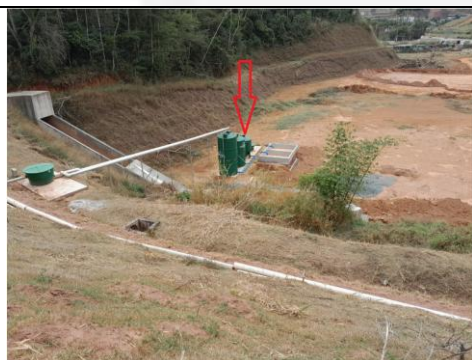
Figura 05: Estação de Tratamento de Efluentes instalada.
