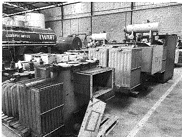
Transformadores estocados para manutenção em local fechado e impermeável.
