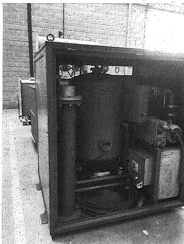
Termo-vácuo utilizado para a retirada do óleo isolante dos transformadores.
