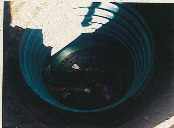
Foto. 06 – SUMP Boca de Visita Tanque
