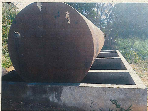
Foto.08- Tanque de óleo usado
