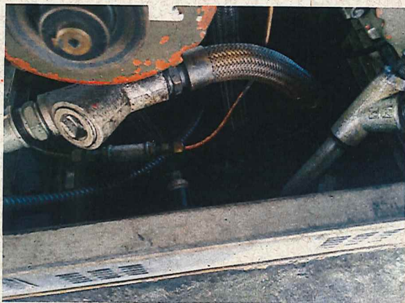
Foto. 05- SUMP Bomba de Combustível
