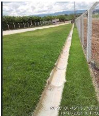
Foto 09. Sistema de drenagem pluvial.
