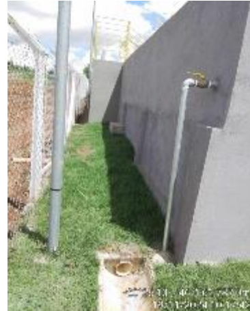
Foto 08. Saída bacia contenção dos tanques.
