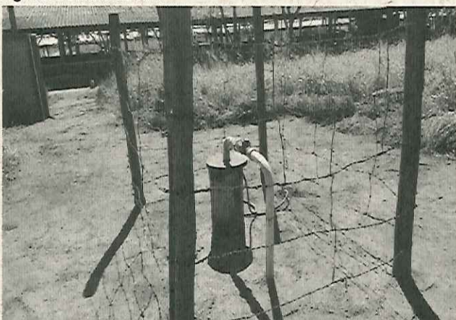
Fig. 15. Captação em poço tubular
