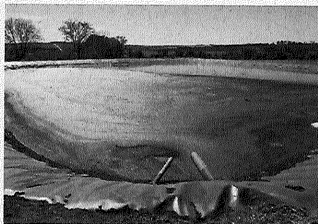
Fig. 3. Lagoa de decantação em operação
