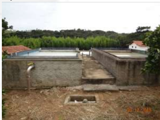
Fig. 11 – Recepção do esgoto sanitário na ETEI
