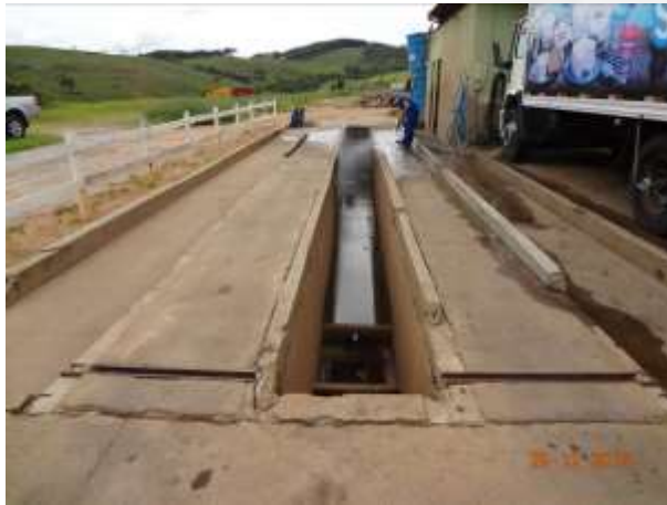
Fig.12 – Lavador de Veículos
