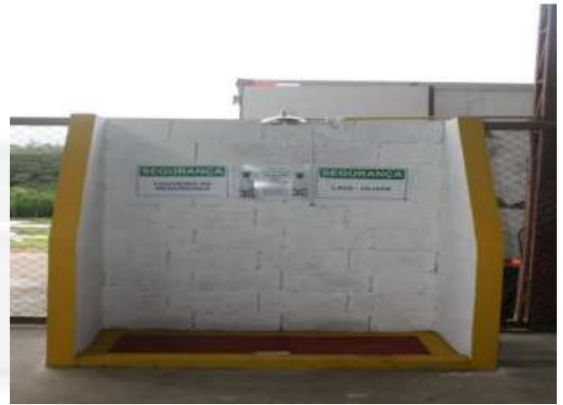
Fig. 22 – Chuveiro de emergência com lavador de olhos.
