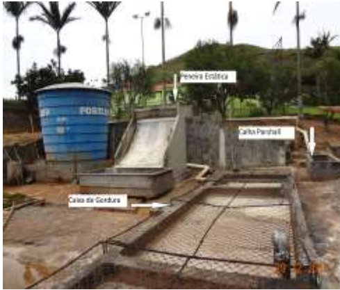
Fig.06 – Início do Sistema da ETEI.
