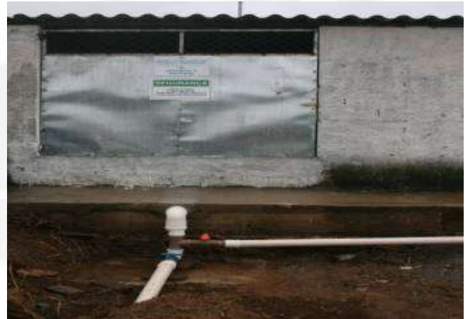
Fig.16 – Local de armazenamento de resíduos classe I, com bacia de contenção e sistema de condução para possíveis vazamentos.
