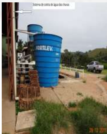
Fig. 04 – Um dos pontos de coleta e armazenamento de águas pluviais.
