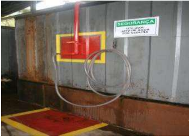
Fig. 21 – Ponte de água para aspersão em caso de acidente com sistema de amônia, próximo aos tanques.
