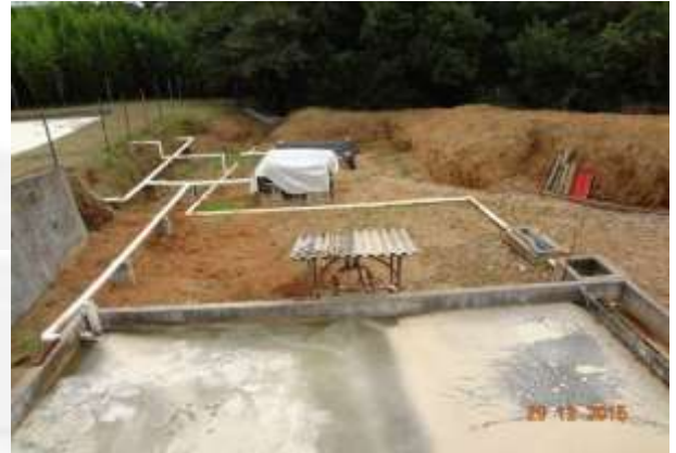
Fig. 07 – Final do Sistema da ETEI, e tubulação de lançamento em corpo receptor.
