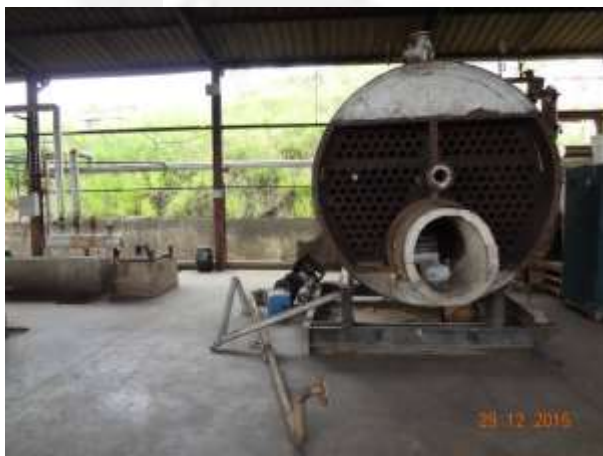
Fig.17 – Caldeira Ata desativada por recomendações técnicas.
