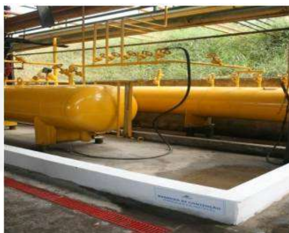
Fig. 20 - Vista dos Tanques de amônia
