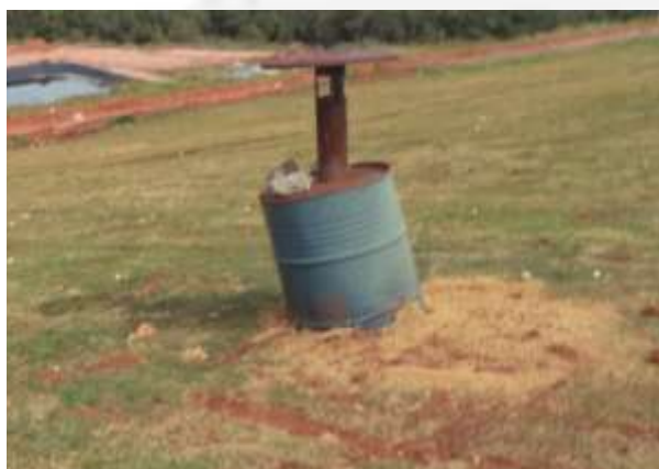
Figura 9 - Drenos de biogases instalados no atual Aterro Sanitário de Alfenas.
