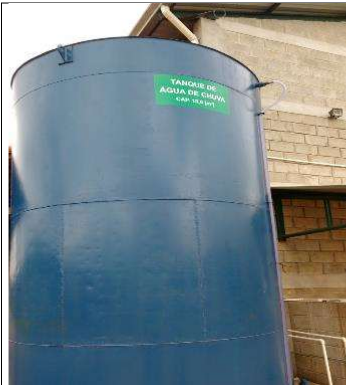
Tanque de água de chuva
