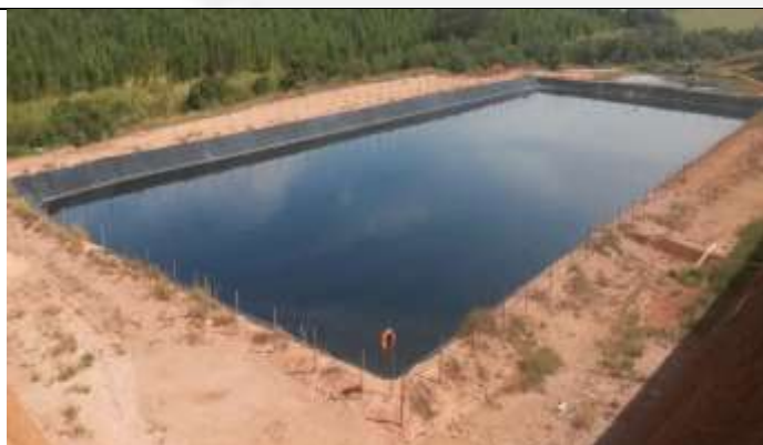
Lagoa facultativa da ETE
