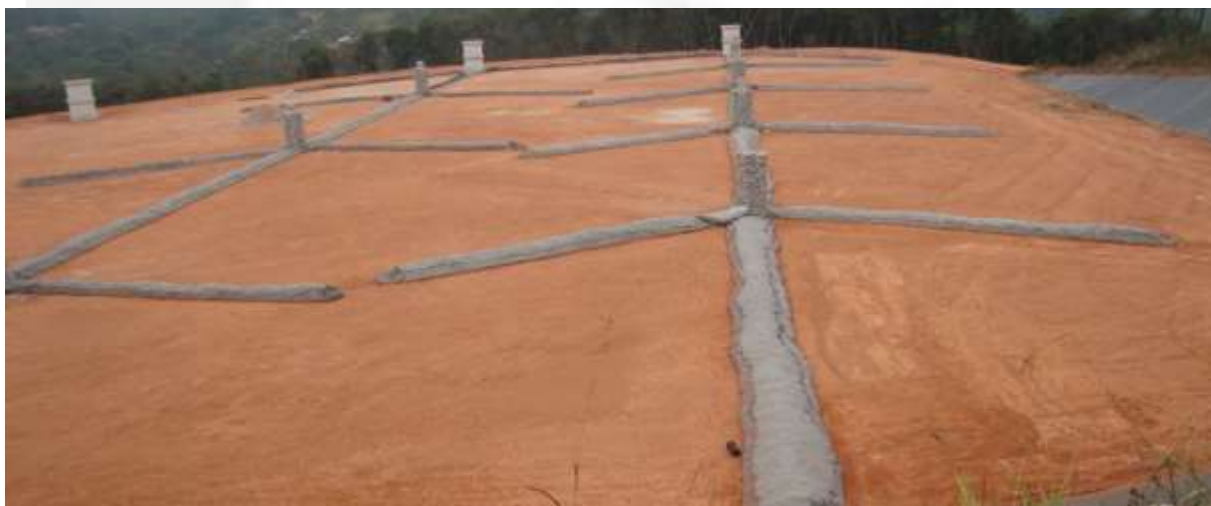
Figura 8 - Drenos DEH e DEV, na forma de espinhas-de-peixe, instalados na base da Unidade de Aterragem de um aterro sanitário (Foto meramente ilustrativa)
