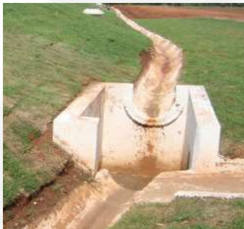
Figura 13 - Dispositivos de drenagem de águas pluviais (foto meramente ilustrativa)
