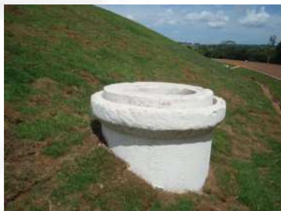
Figura 10 - Caixa de transição de efluentes (CTE) instalada em um aterro sanitário
