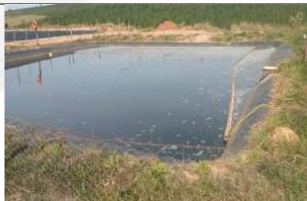
Lagoa anaeróbia da ETE
