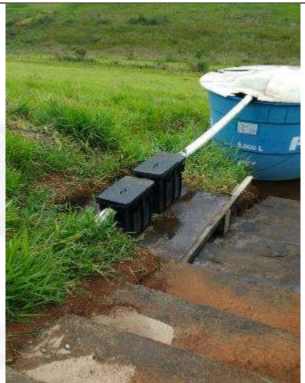
Tratamento de efluentes
