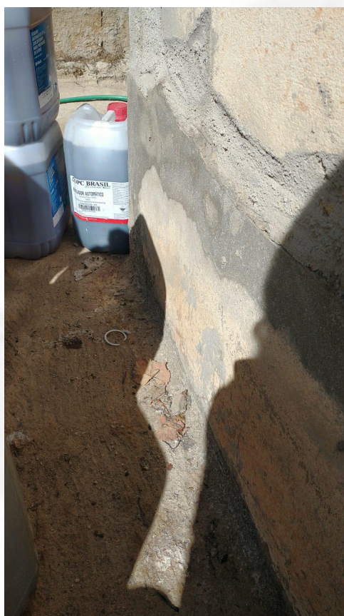
Figura 04: Galões cheios com revelador e fixador automático em local sem cobertura e contenção. Fonte: Vistoria – 16/07/2021.
